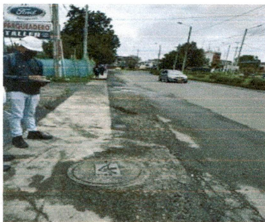
Estado de la calzada Norte – sur Carrera 9
