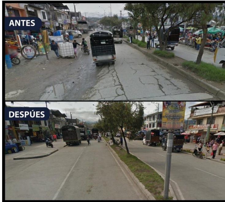
Figura 9. Antes y después de la obra en la Calle 5 entre carreras 17 y 19 (sector galería de la esmeralda).
